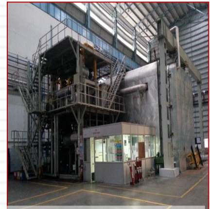
Installation de séchage de la phase vapeur
